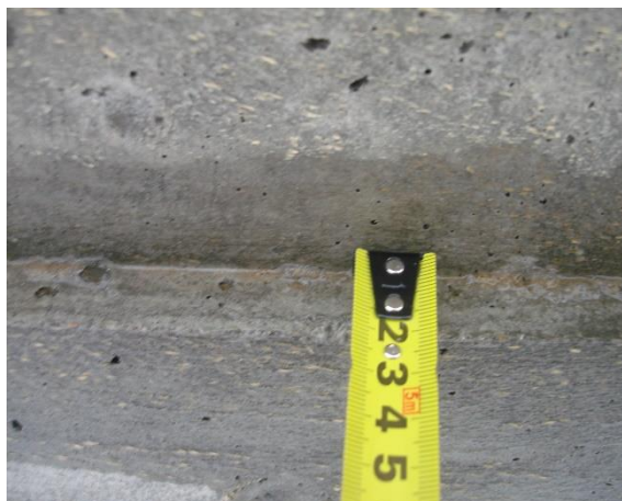
Деформация «выдавливание» опалубки.
