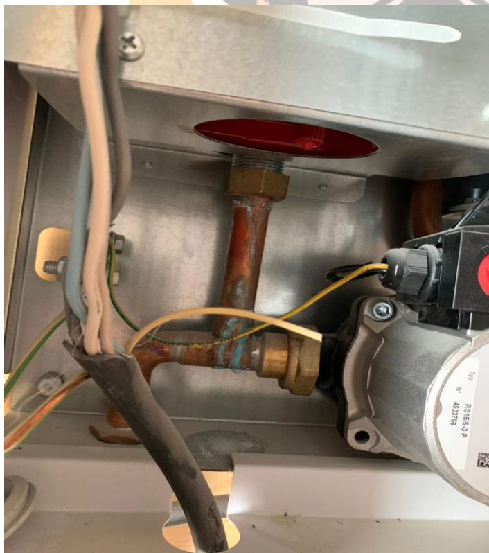
Течь в электрокотле.
