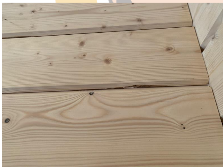
Место на наружной стене с биопоражением.
