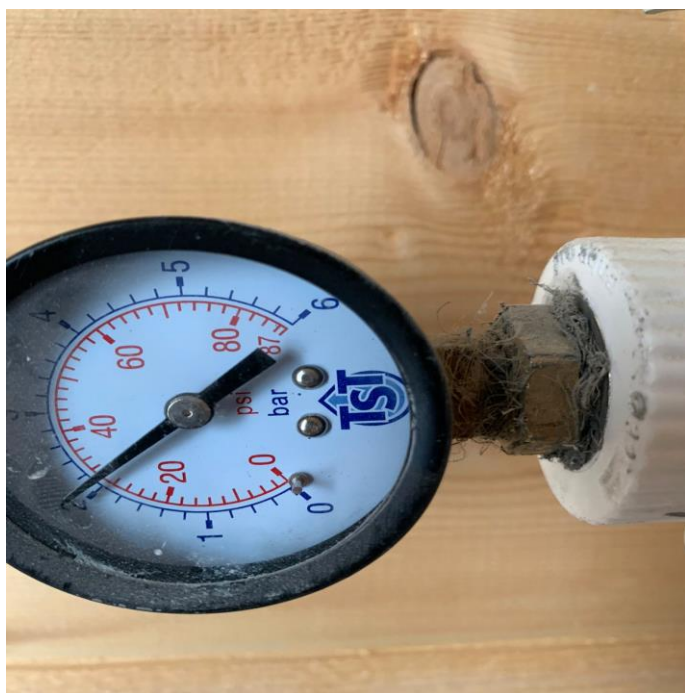
Давление холодного водоснабжения на вводе.
