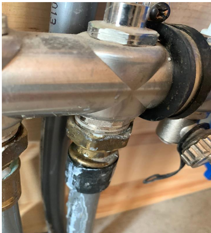
Течи соединений в котельной.
